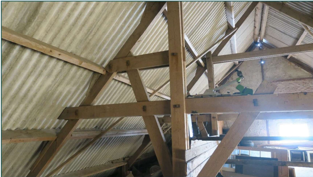
Figuur 3.1 Op de zolder van de schuur is er een hoge mate aan lichtverstoring en tochtwerking.
