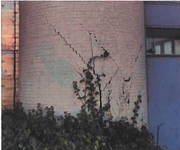
Figuur 3. Scheurvorming in het pand waarin de verblijfplaats zich bevindt.
