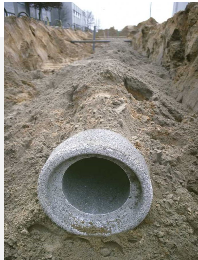
Figuur 2 De aanleg van een rioleringssysteem heeft veel voeten in de aarde. Bron: GAW | Stichting RIONED
