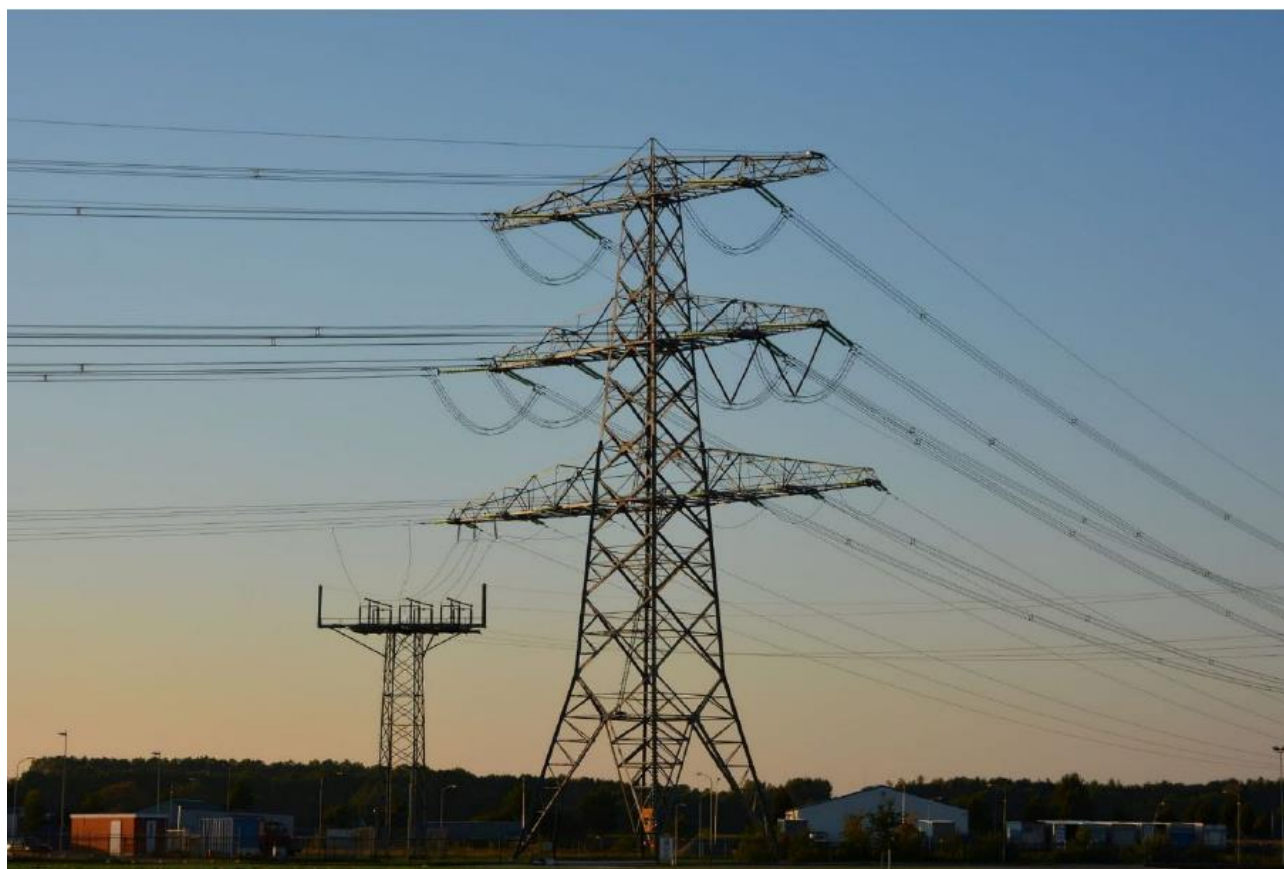
Figuur 13 mast 184 en mast 184A
