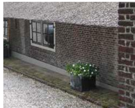
Afwijkende verharding tegen de gevel.
