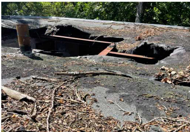
Bitumendak met gat als gevolg van brand
