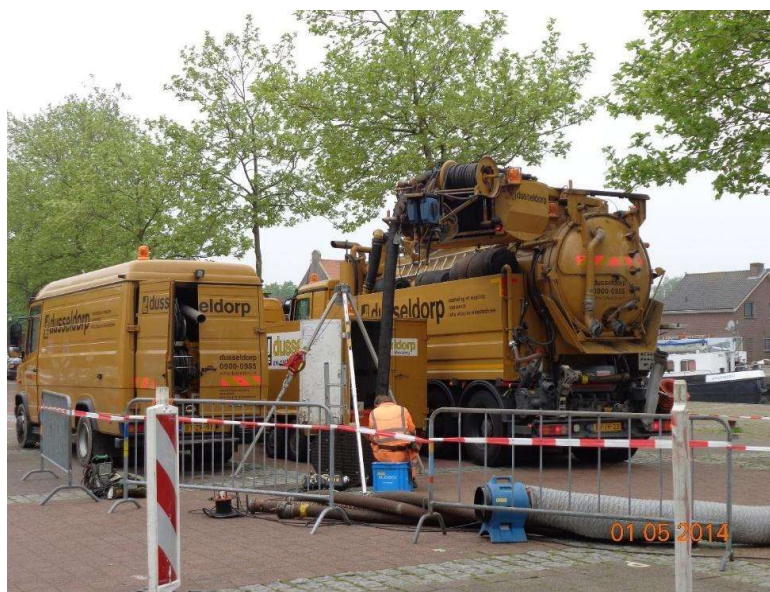
Figuur 9.1 Rioolinspectie en -reiniging
