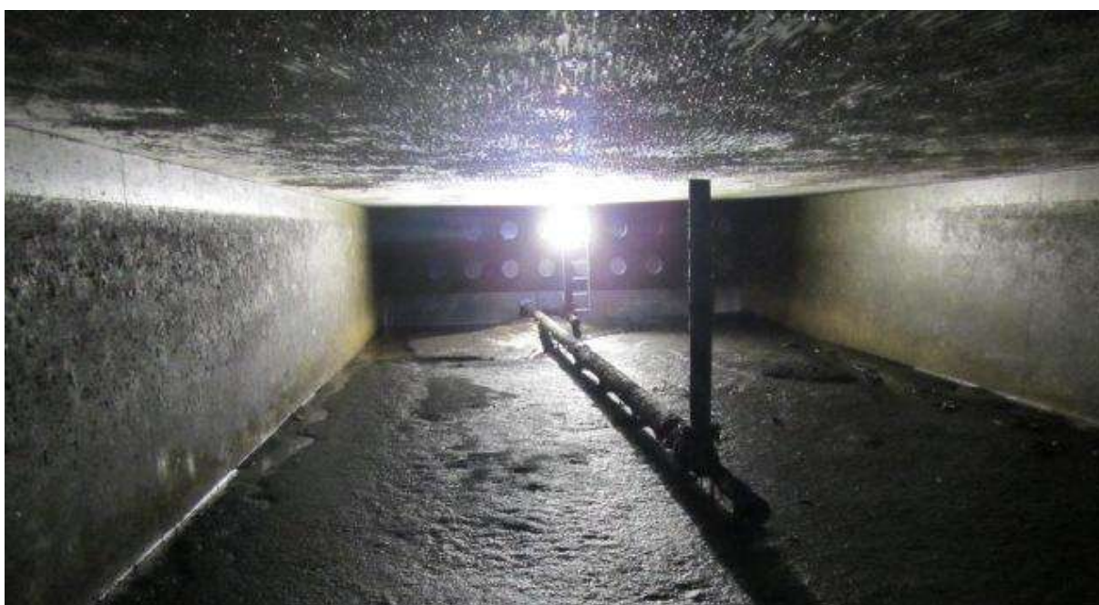
Figuur 9.2 Onderhoud pomp van een bergbezinkbassin (boven) Bergbezinkbassin Horstweg Hoevelaken (onder)
