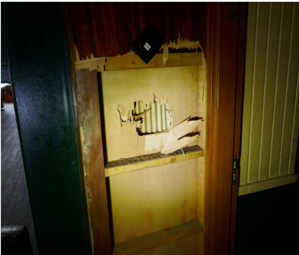
Afb. 4.22 Net buiten 0.04a is via een beschadiging in later plaatmateriaal een achterliggende leren schuifwand te zien. De houten wanddelen rechts zijn dezelfde als die uiterst links op 4.20 zijn te zien.
