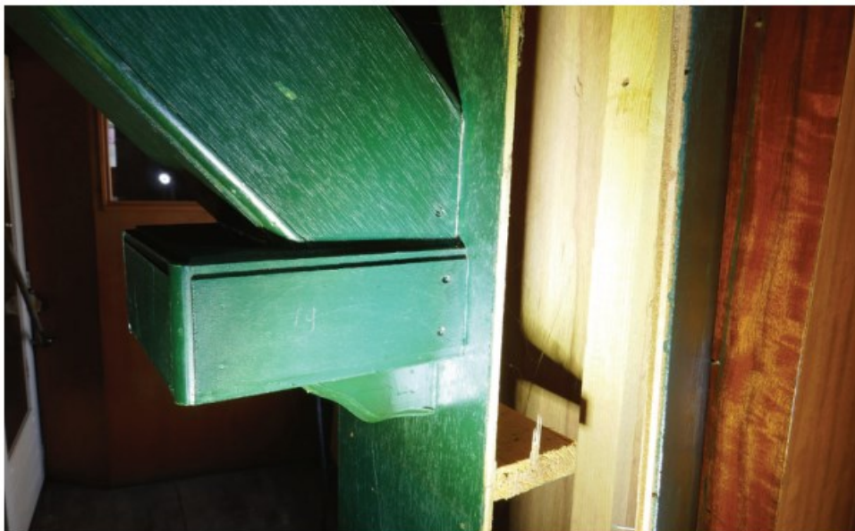
Afb. 4.17 In ruimte 0.01 zijn diverse groene balkconstructies aanwezig (zie bijv. 4.15). Deze bleken bij nadere inspectie volledig van plaatmateriaal te zijn gemaakt en binnenin geheel hol te zijn.
