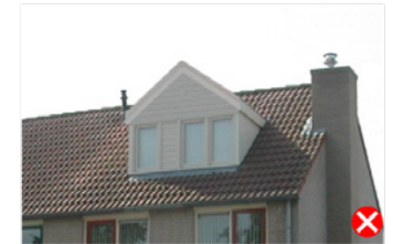
vormgeving sluit niet aan op stijl van woning
