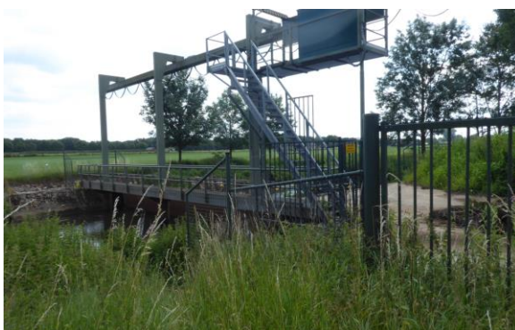
Afbeelding 8. Vuilopvanginstallatie op de zuidgrens van deelgebied 2.
