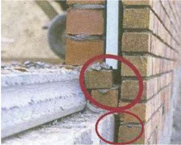
Isolatiemateriaal is niet goed doorgezet waardoor er een koudebrug ontstaat (bron: Nieman)
