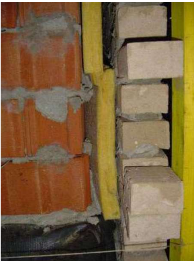
Isolatiemateriaal sluit niet goed op elkaar aan
