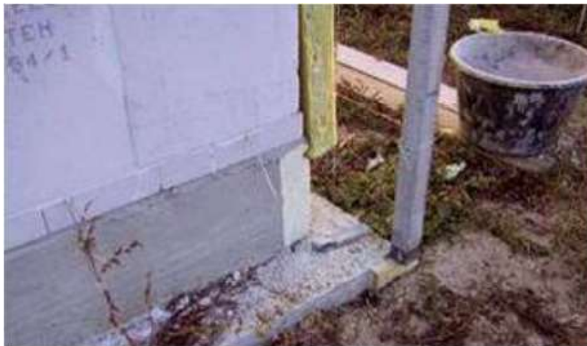
Isolatiemateriaal sluit niet goed aan op omliggende constructies
