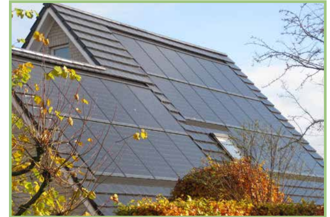
Zonnepanelen geïntegreerd in het dakvlak
