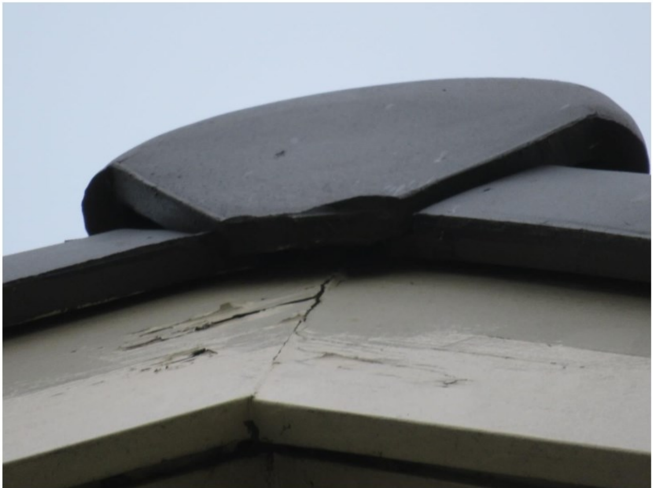
Afbeelding 7: De nok- en kantpannen aan beide gevels sluiten goed aan.
