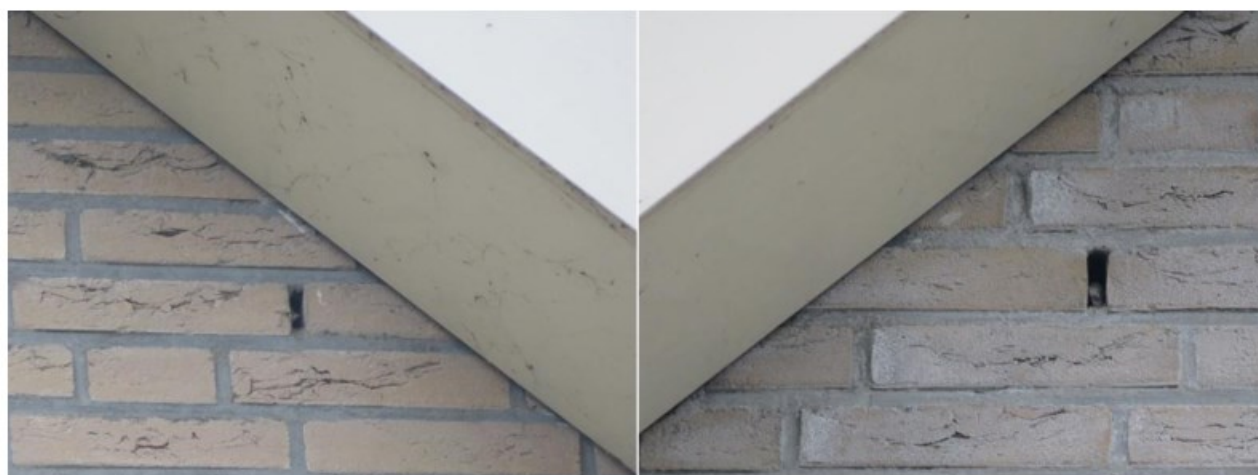
Afbeelding 6: Enkele van de open stootvoegen in de woning.
