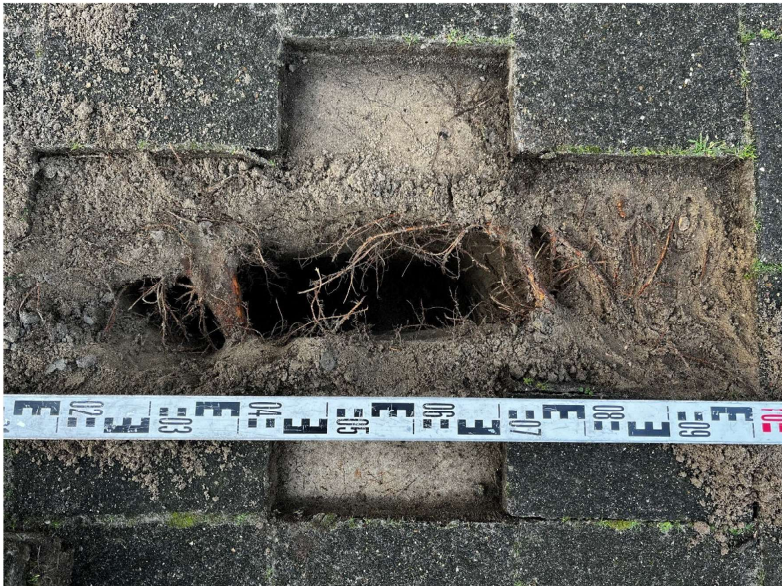
Afbeelding 2: Direct onder de verharding wordt op een aantal locaties een intensieve beworteling aangetroffen
