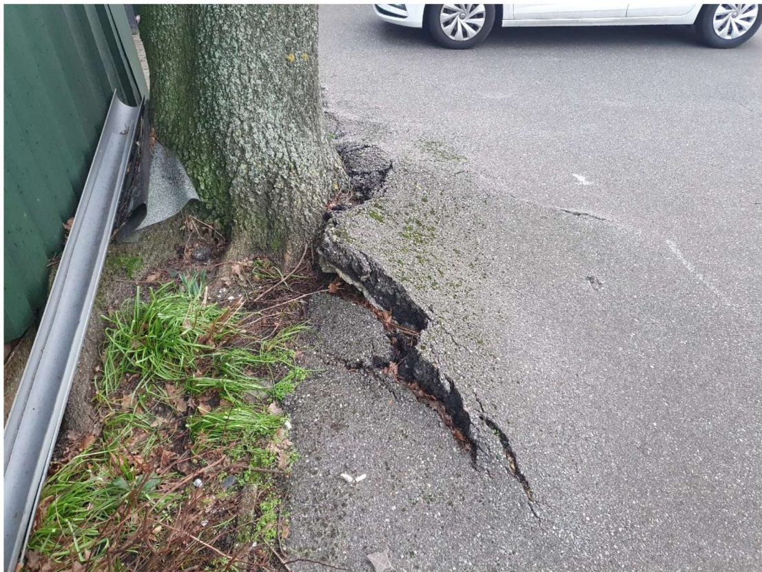
Figuur 2 Opgedrukt asfalt door Quercus robur
