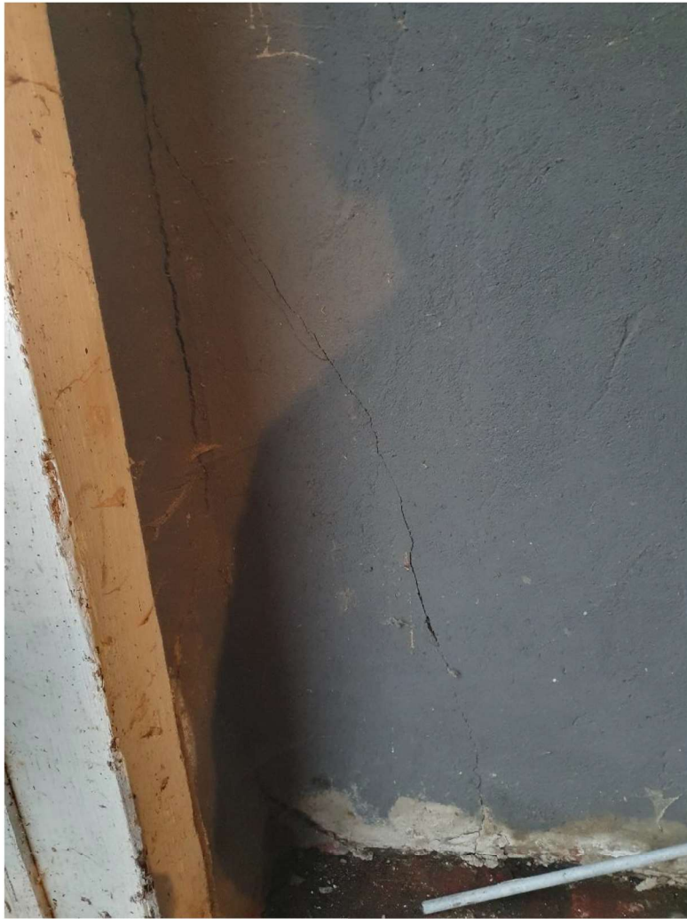
Figuur 2 Beschadiging schuur en fundering (binnenkant schuur)
