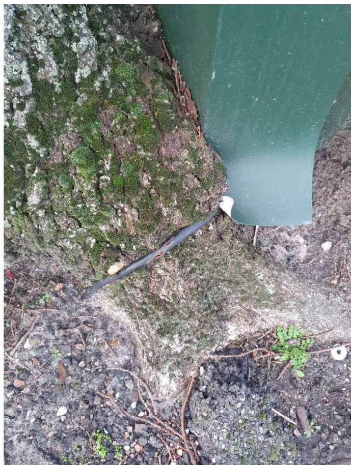
Figuur 3 Beschadiging kabel en schuur
