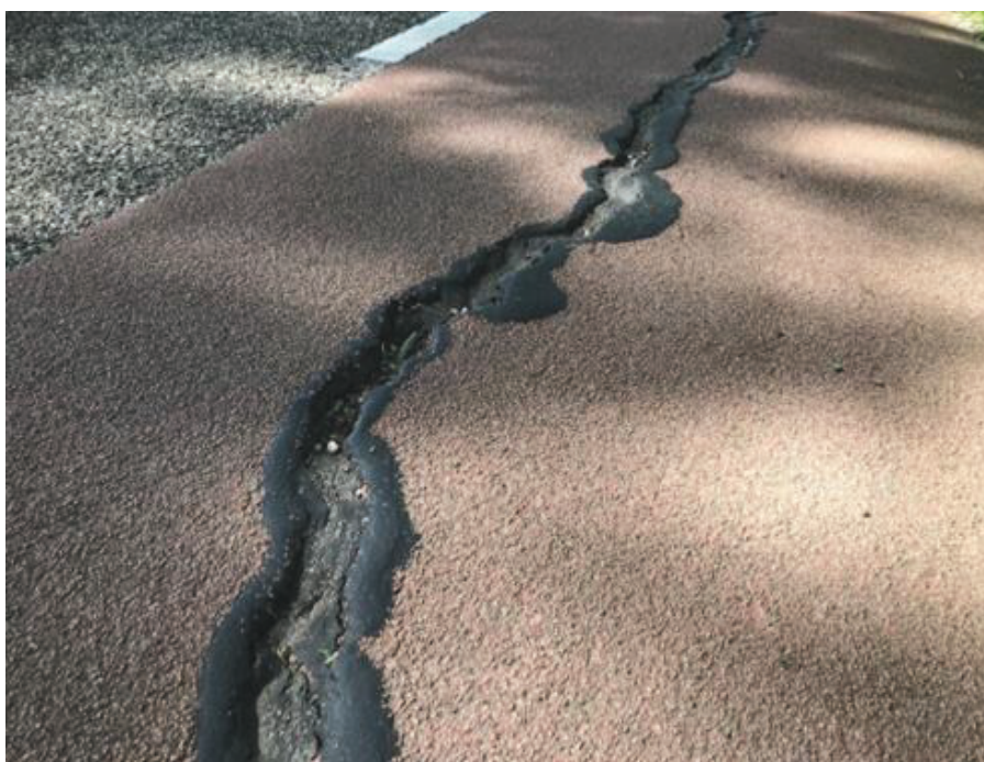
Figuur 2: Foto scheurvorming ter plaatse van weg Winterdijk
