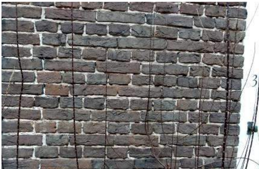
Figuur 3: Erosie van het voegwerk in de gevel op het zuiden links van de ingang van woning 3
