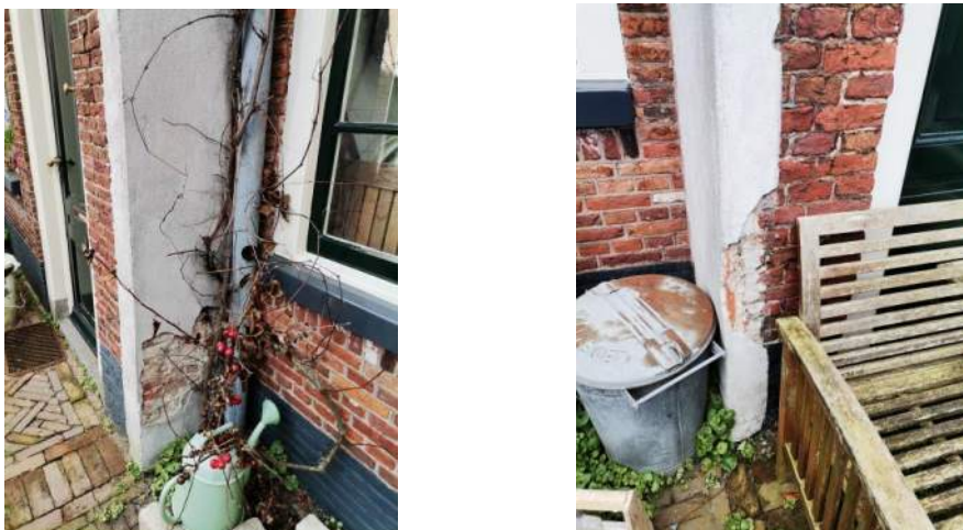
Figuur 12: Aangetast pleisterwerk in gevel woningen 5 en 6
