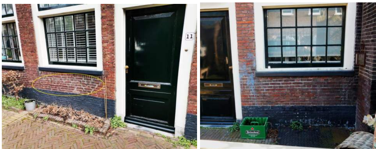
Figuur 9.1: Links reparatiwerkzaamheden onder raamkozijn van woning 11. Rechts: reparatie metselwerk rechts van de deur en boven de deur van woning 12.
