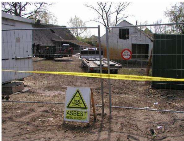
Figuur 4.11: Afscherming van een asbestverdachte locatie
