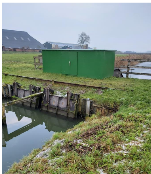
Afbeelding 1: huidig gemaal Oldenoord
