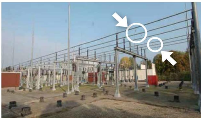
Figuur 10 Afbeelding dubbel hoofdrail (rail A en rail B) in bestaand hoogspanningsstation
