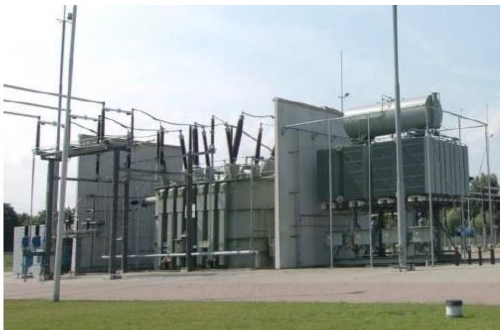
Figuur 12 Foto van bestaande TenneT transformator in transformatorcel en daarnaast een koelercel met transformatorkoeler op bestaand station
