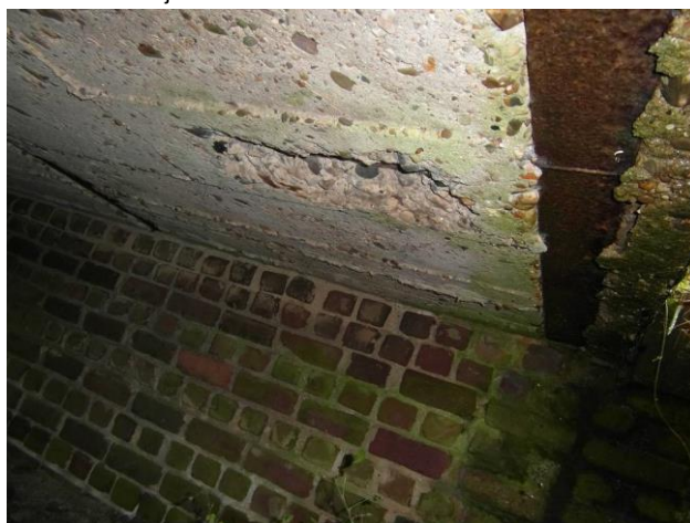
Foto 6: aanzicht stalen balk en dekkingschade
