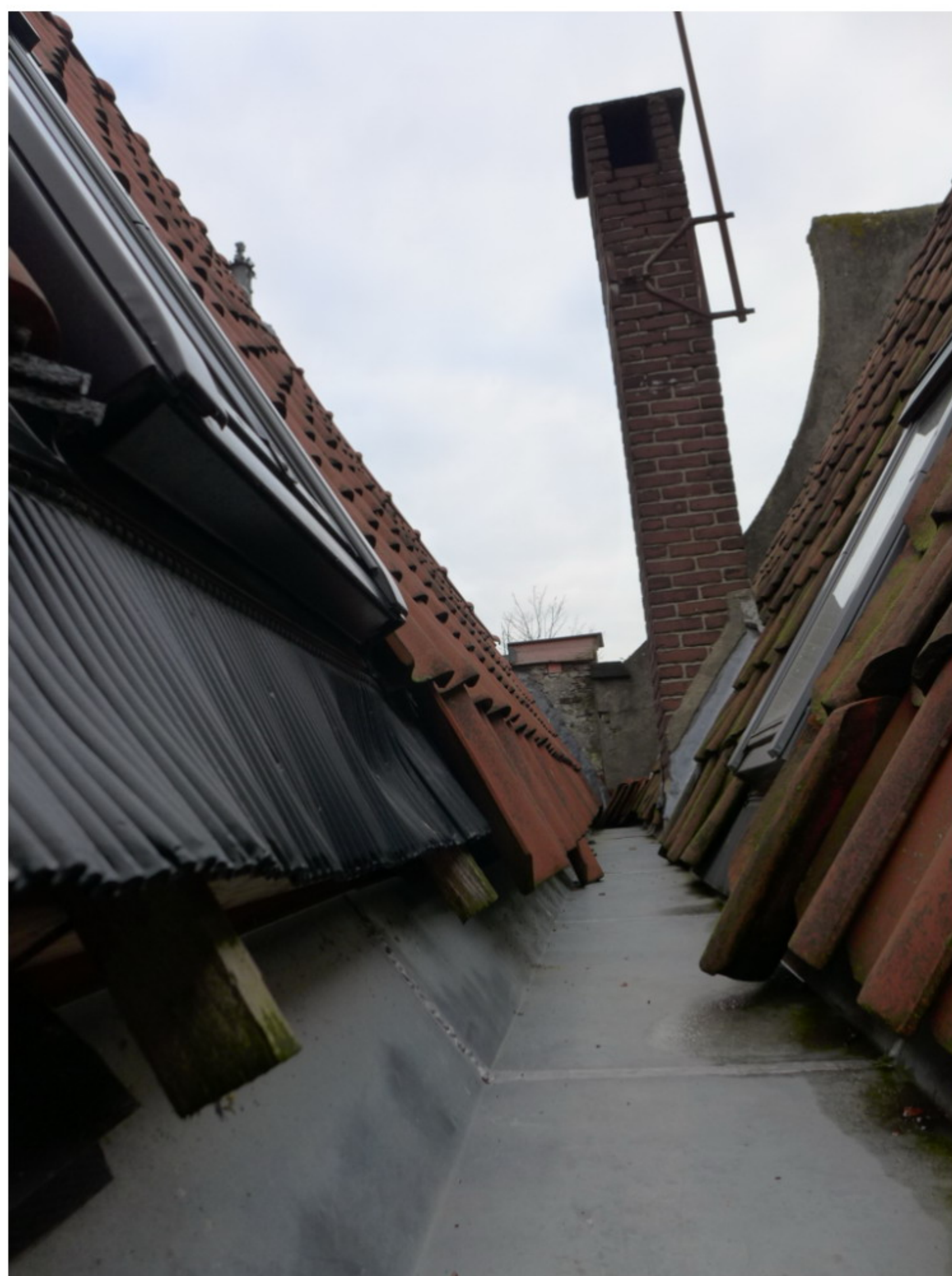
13 onderkant dakramen linker goot
