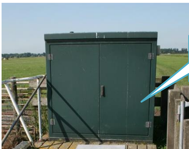
Bedieningskast en instrumentaria
