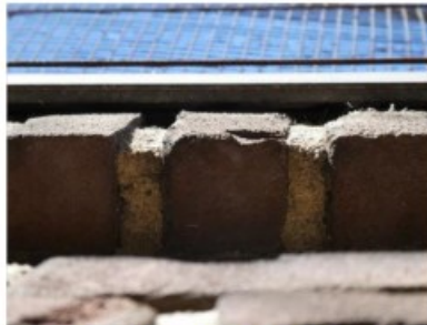
Figuur 5.2 Ruimte onder de metalen strip waar vleermuizen in kunnen kruipen, maar onvoldoende ruimte voor potentiële verblijfplaatsen.
