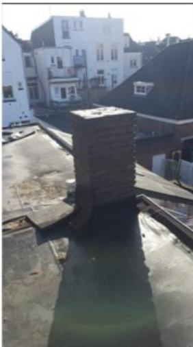
Figuur 5.4 Dichtgemetselde schoorsteen (zelfde schoorsteen als in figuur 5.3), biedt geen openingen voor gebouwbewonende vleermuizen (Statt, 2023).
