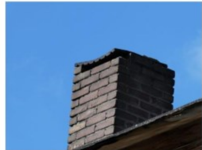
Figuur 5.3 Schoorsteen met daar bovenop een rubberen flap, biedt geen toegang voor gebouwbewonende vleermuizen.
