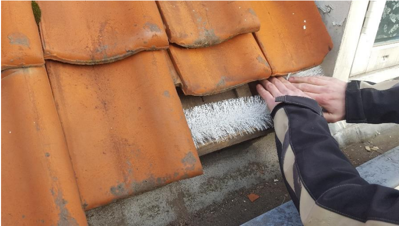
Figuur 11 Ontmoedigingsmaatregel huismus; spouwborstels plaatsen ter hoogte van de eerst rij dakpannen.
