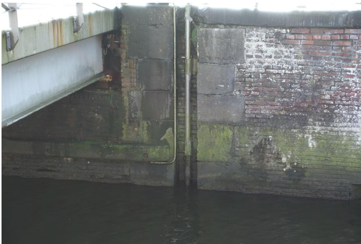
Figuur 117. Bij de aansluiting op de brug werd de vleugelmuur al in 1912 verhoogd, waarbij ook de schotbalkensleuf werd verhoogd.
