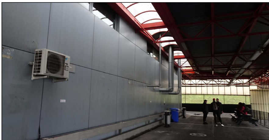
Figuur: luifel zuidzijde te handhaven gebouw, waar broedvogels zich kunnen vestigen op stalen balken.
