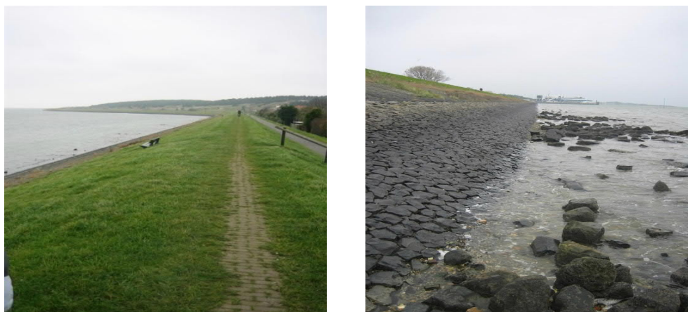
Figuur 5: Links de situatie vanaf de kruin en rechts de situatie gezien vanaf de teen van de dijk. Foto's: RHDHV
