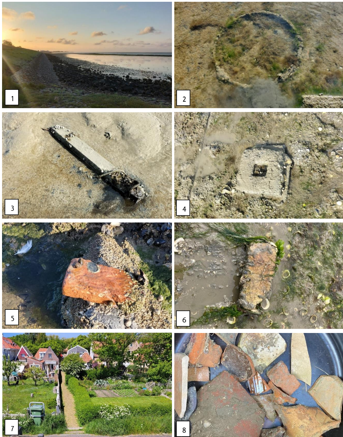
Afbeelding 15: Vondsten tijdens de veldinspectie. 1) Kreukelberm met losse stortsteen; 2) Een van de twee ijzeren ringen met fundatie eronder; 3). Betonnen paal met wapening; 4) Betonnen poer; 5) Rode baksteen; 6) Gele baksteen; 7) Steeg met gele baksteen aan binnenzijde van de dijk; 8) Selectie van verzamelde vondsten. Bron foto's: Saricon.
