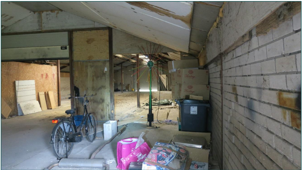
Figuur 4 In loods 2 is er dakbeschot aanwezig..
