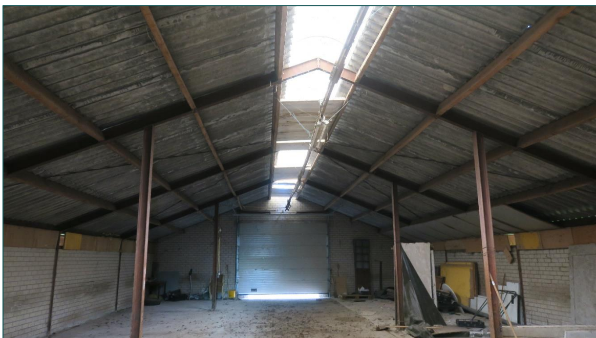
Figuur 2 In loods 1 is er geen dakbeschot aanwezig.
