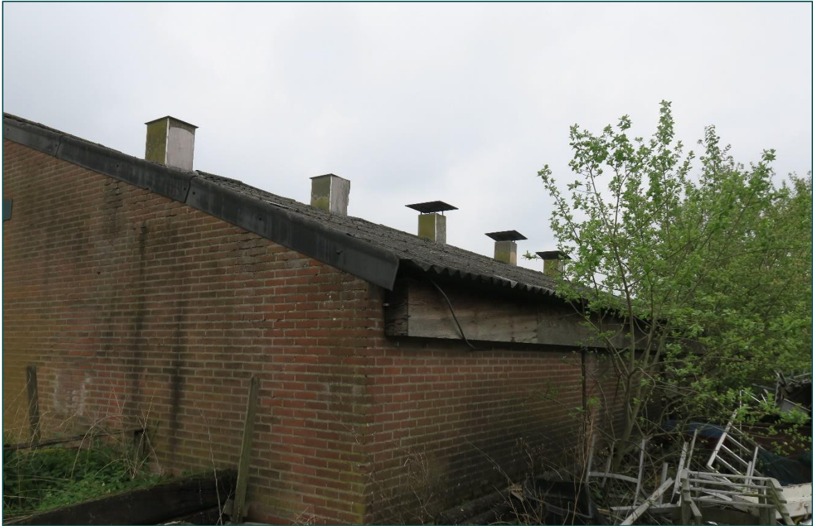
Figuur 3.1 De daken van beide loodsen zijn volledig afgesloten. Hierdoor kunnen er geen huismusnesten aanwezig zijn in de loodsen.
