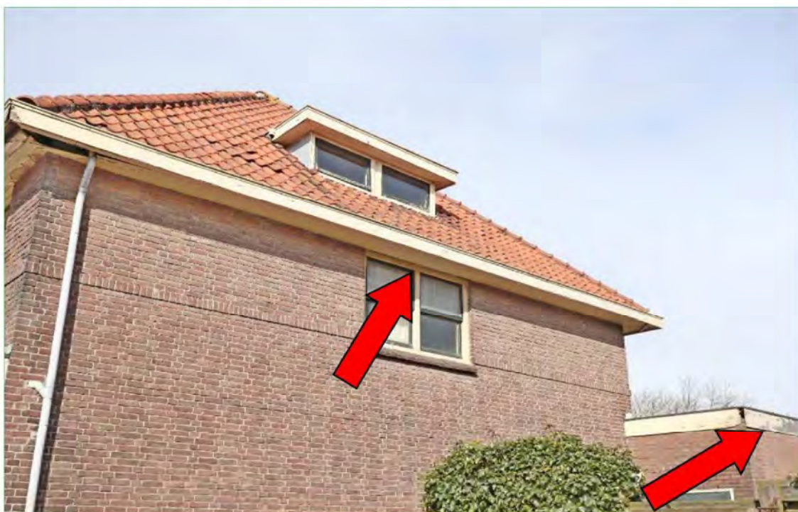
De openingen achter boeidelen en achter een daklijst (rode pijl) aan de zuidoostzijde van de bebouwing geven mogelijk toegang tot voor vleermuizen geschikte achterliggende ruimtes.
