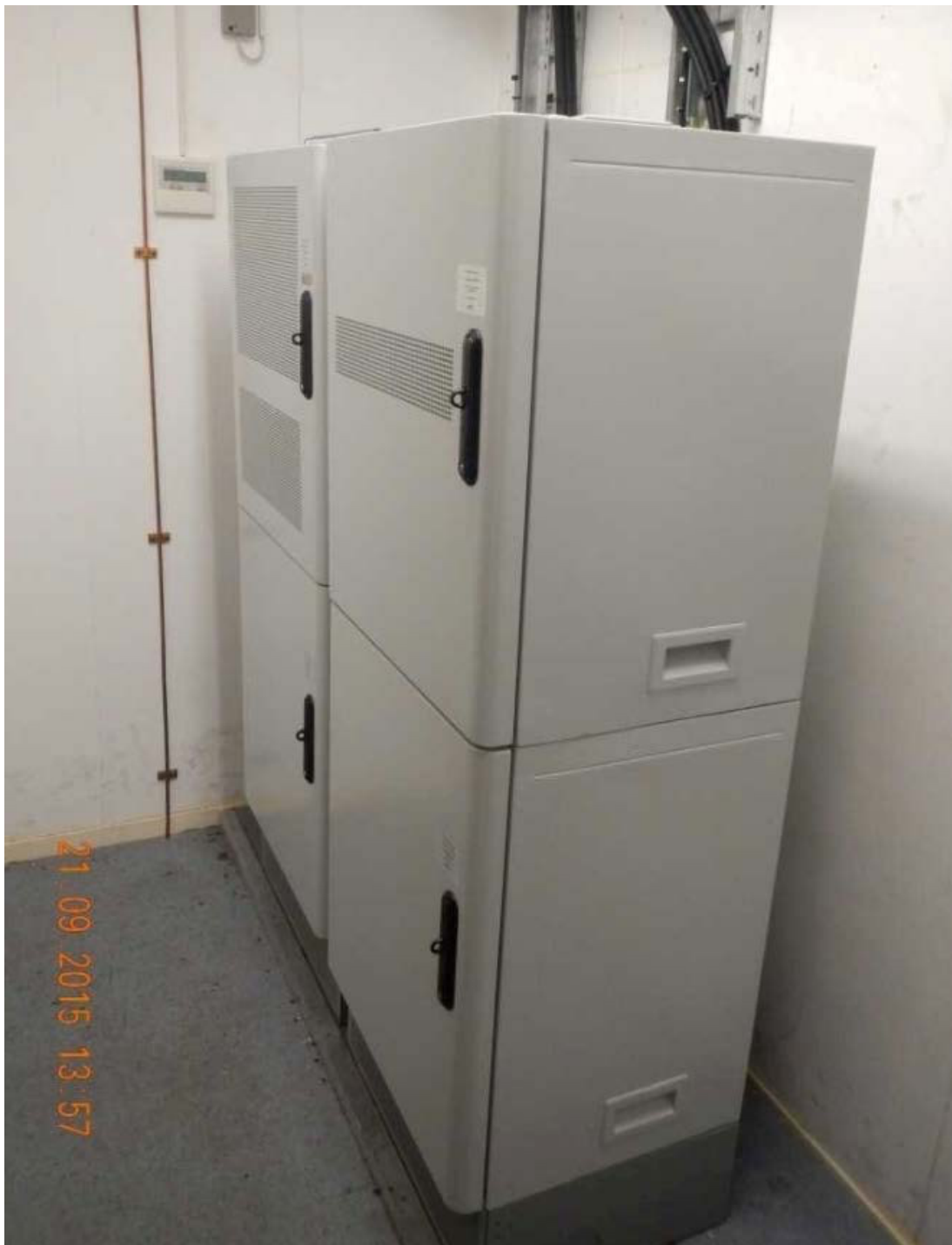
Afbeelding 5 Bestaande apparatuur kasten.
