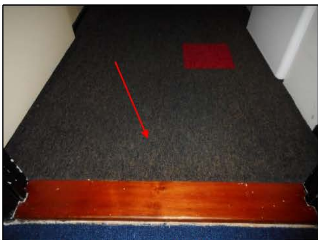
Foto 3: Keuken: Onderlaag vloerzeil (M01AA)
