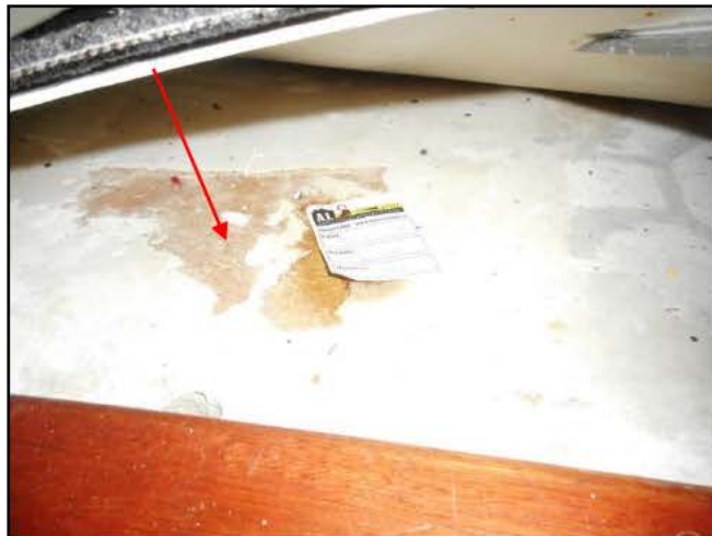
Foto 2: Keuken: Onderlaag vloerzeil (M01AA)
