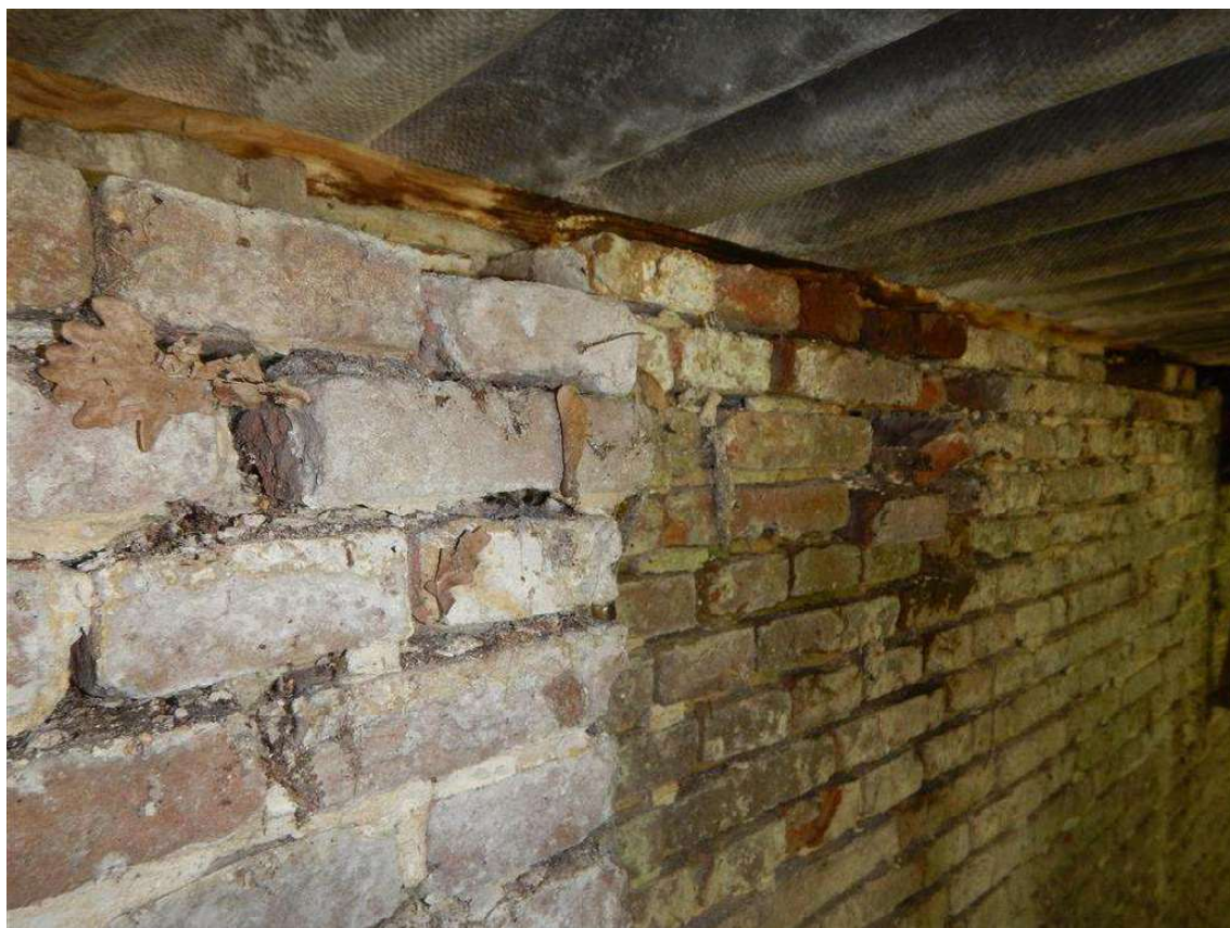
09 Door langdurige lekkage is de bovenzijde van de muur slecht door verwaterd en losliggend metselwerk, hieraan is het meeste herstel te verwachten in combinatie met rollaag afwerking.
