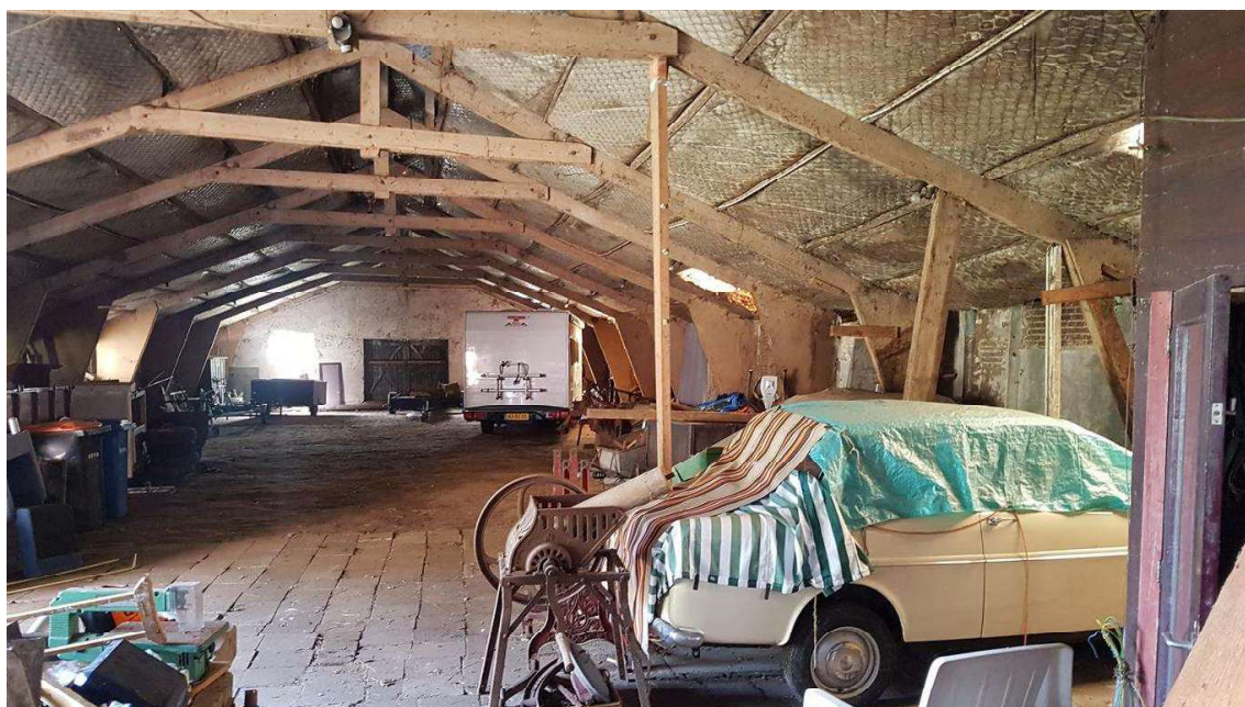
04 In slechte staat verkerende schuur, hier overzicht vanuit het woongedeelte naar achteren.
