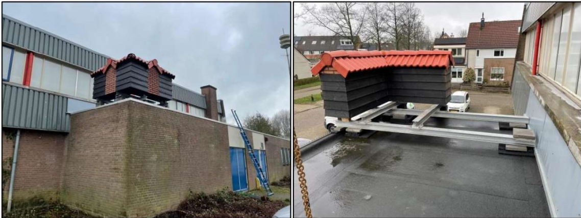
Foto's 7 en 8. Links de tijdelijke laatvliegerkast gezien vanaf de aanvliegszijde. Rechts de laatvliegerkast gezien vanaf de achterzijde.
