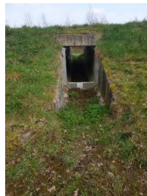
Figuur 53 Sluiskens (inlaatconstructie)
