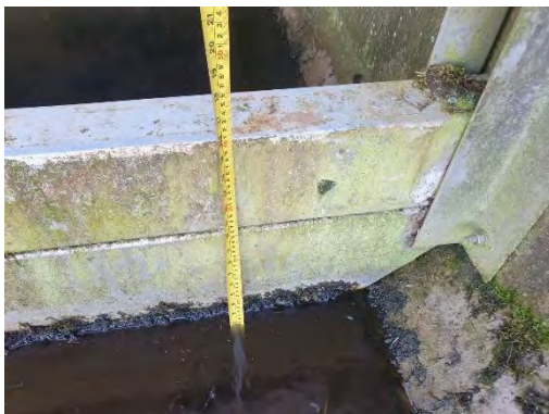
Figuur 78 Extra schotbalken boven onderkant inlaatconstructie Mortelbeek
