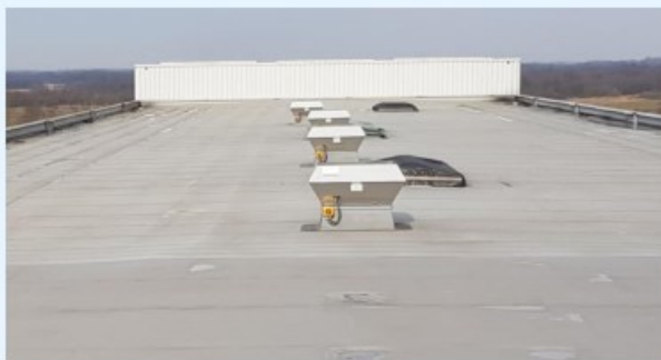
figuur 7: afzuigunits dak hal 3 (akoestisch niet relevant)
