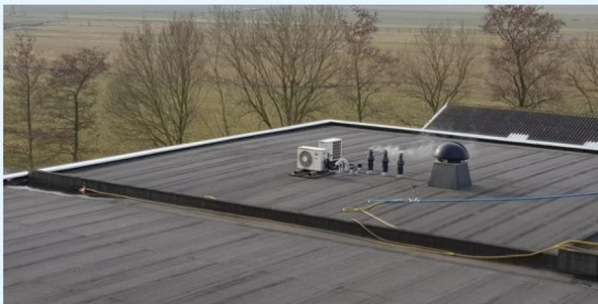
figuur 8: afzuiging en airco-units dak hal 1
