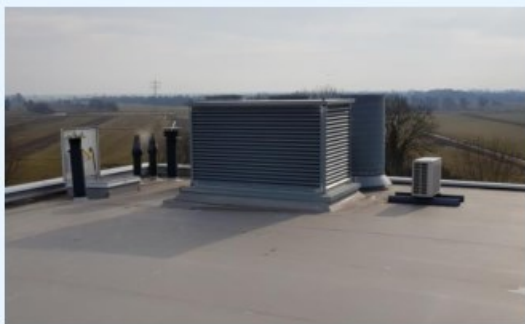
figuur 6: LAK, airco en afvoerpijpen dak hal 3
