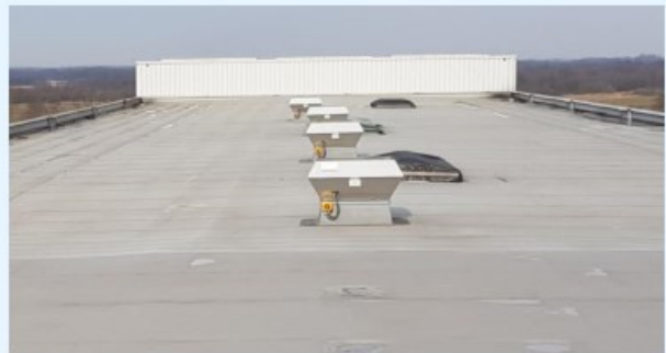
figuur 7: afzuigunits dak hal 3 (akoestisch niet relevant)
