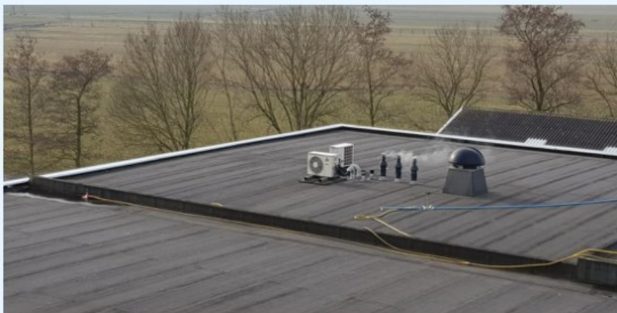
figuur 8: afzuiging en airco-units dak hal 1
