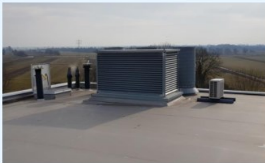
figuur 6: LAK, airco en afvoerpijpen dak hal 3
