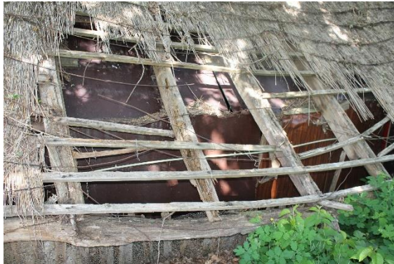
Figuur 3 gaten in het dak met verrotte constructie
