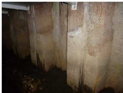
Figuur 4.1: Corrosie op de damwanden
