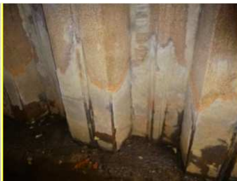
Figuur 4.2: Corrosie op de damwanden
