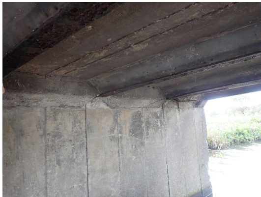
Carbonatatie t.p.v. opleggingen
