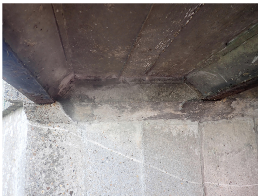
Carbonatatie t.p.v. opleggingen
