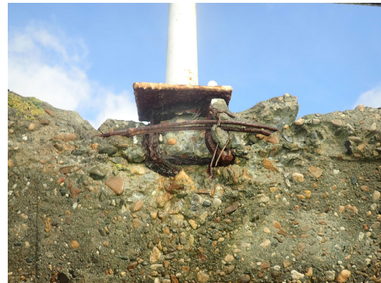
Stijl losgekomen van beton
