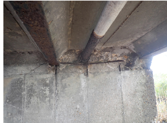
Carbonatatie t.p.v. opleggingen en leiding
