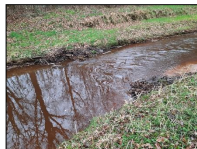
Figuur 18. Doorgebroken dam ter hoogte van Kabroekse Beek.
