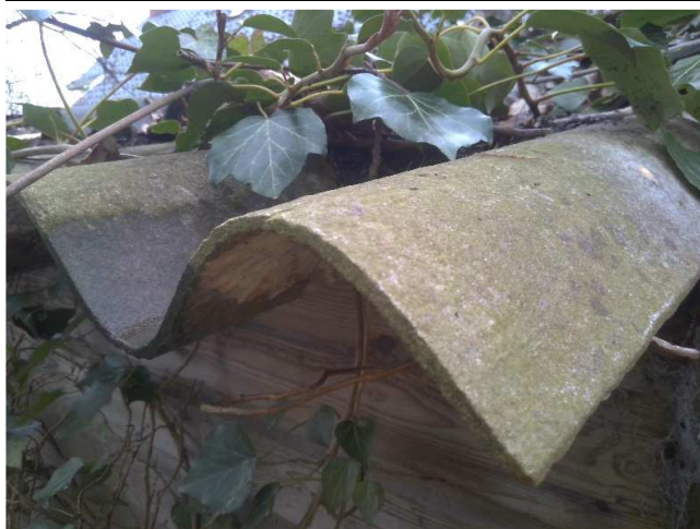
7. asbestverdachte golfplaten op het schuurtje
