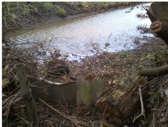
2. Asbestverdachte beschoeiing (vanuit het noordoosten)
