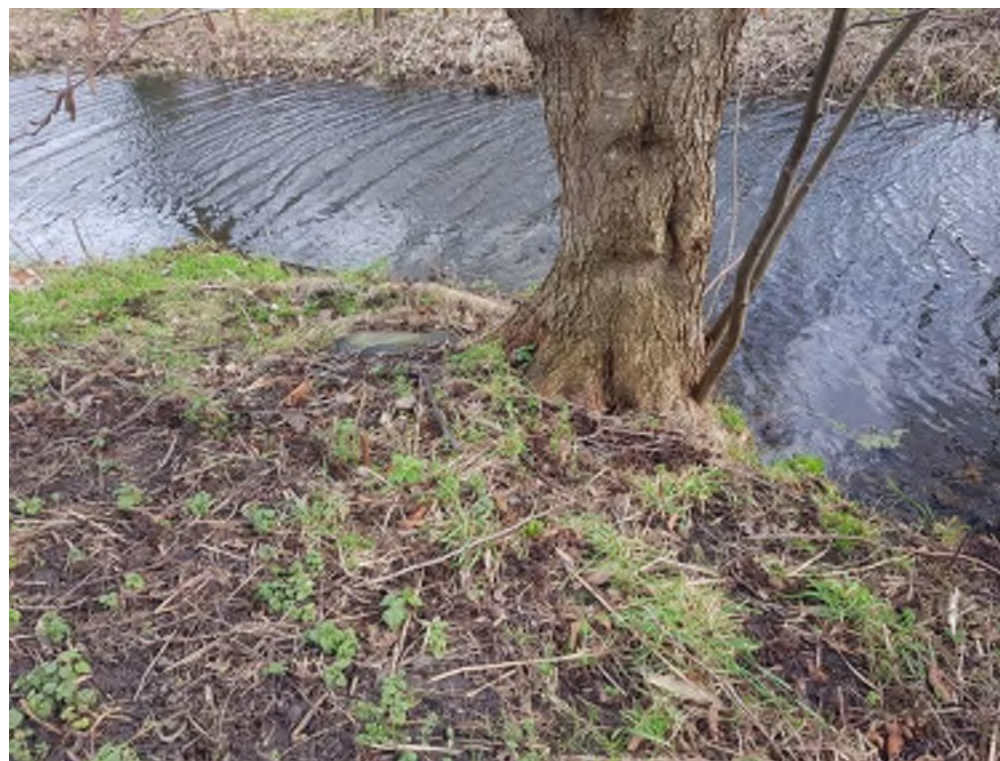
Figuur 8: boom 2 wortels bij beschoeiing (Combigemaal Schuttersveld)
