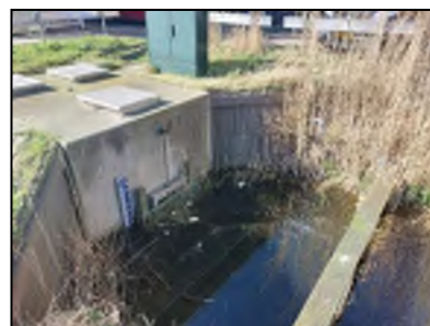
Figuur 7. Overzichtsfoto van het gemaal Besjeslaan te Leiden.
