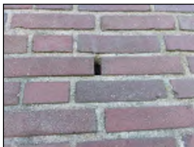
Figuur 15. Open stootvoegen bij het aanwezige gebouw op de onderzoekslocatie te Aalsmeer.
