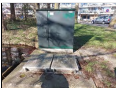
Figuur 11. Overzichtsfoto van het gemaal Pesthuispolder Zuid te Leiden.
