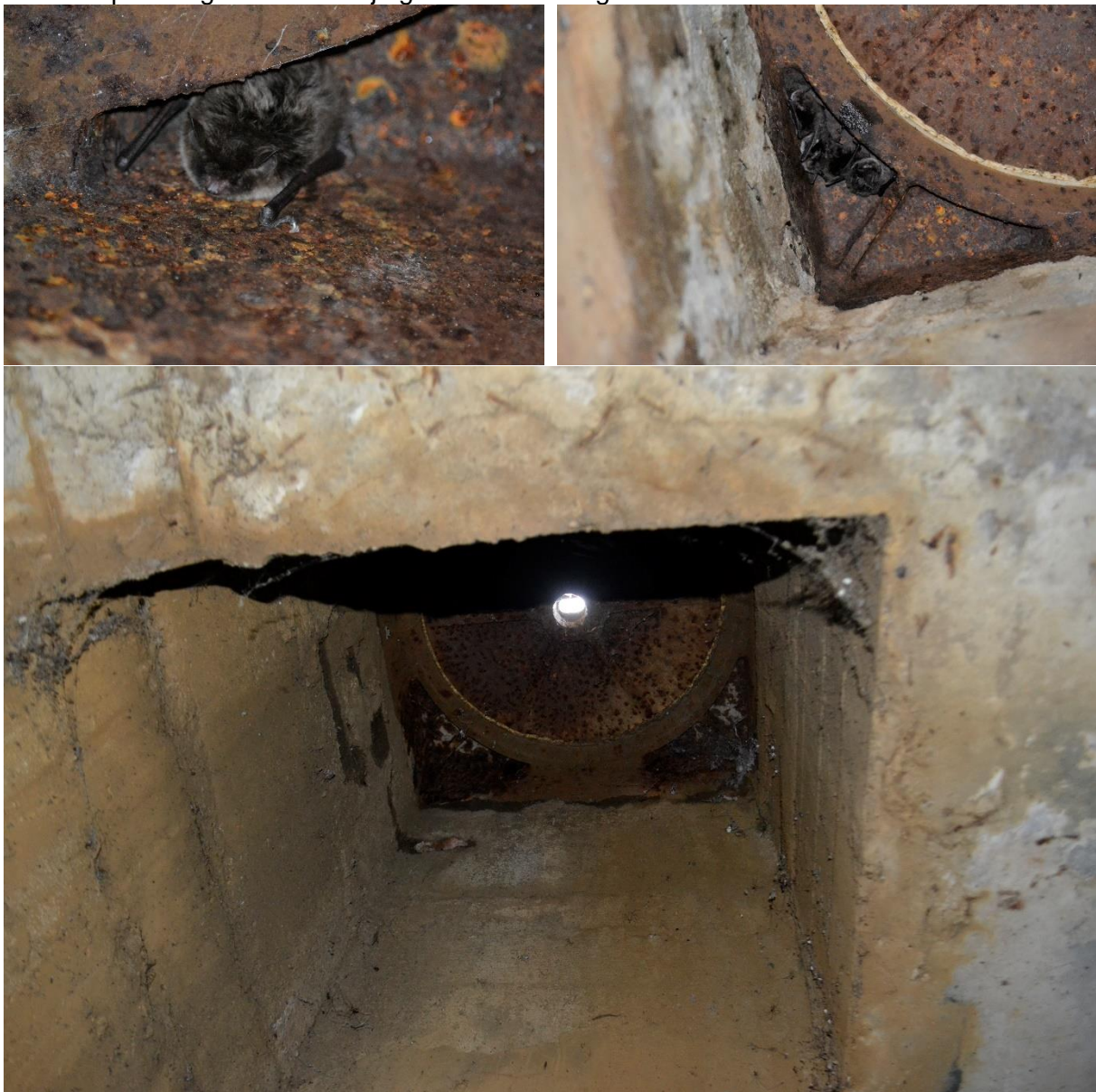
Figuur 3.2 Watervleermuizen hangend in straatkolk.
