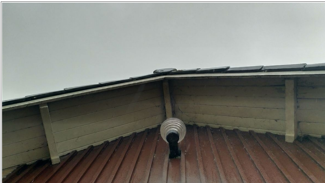
Detail van de onderzijde van de dakoverstekten binnen het plangebied. De overstekende kantpannen vertonen openingen met het dakbeschot welke gebruikt kunnen worden door gebouwbewonende vleermuizen. Foto: M. de Vries / Ecoresult B.V.
