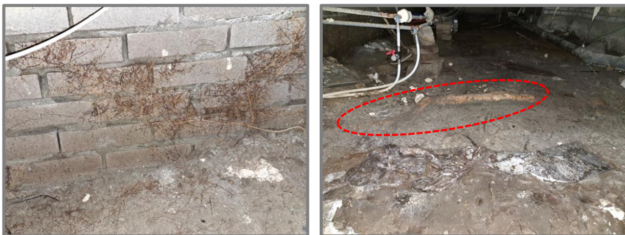
Fig. 2: In de kruipruimte groeit een dicht netwerk van haarwortels op de bodem en op de funderingsmuren (links). Ook zijn er op verschillende dikke boomwortels zichtbaar. Deze transporteren het opgenomen water met voedingselementen richting de boom (rechts).
