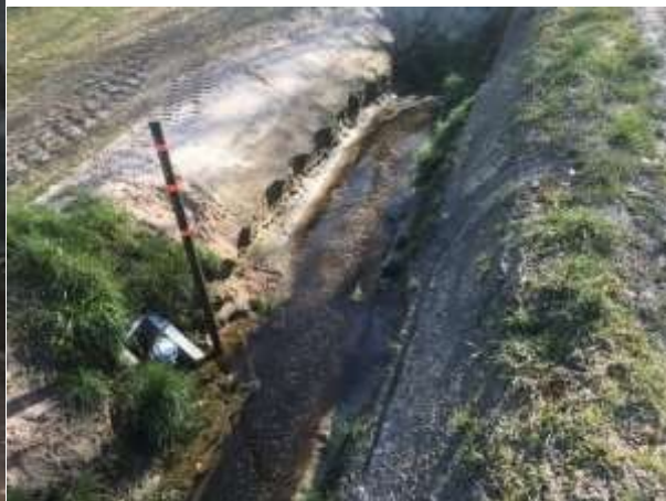
Foto: lozingsvoorziening drainage
