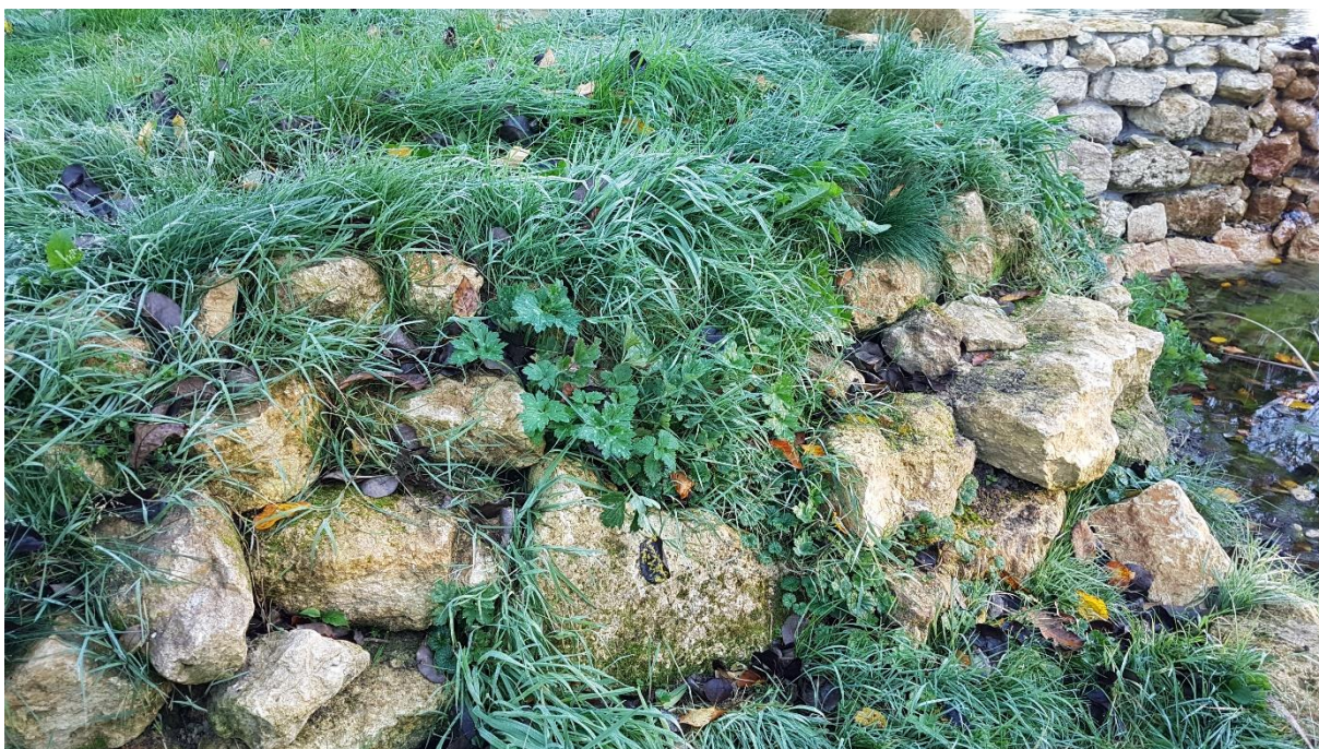
Foto 15: de openingen en scheuren tussen de sierstenen.
